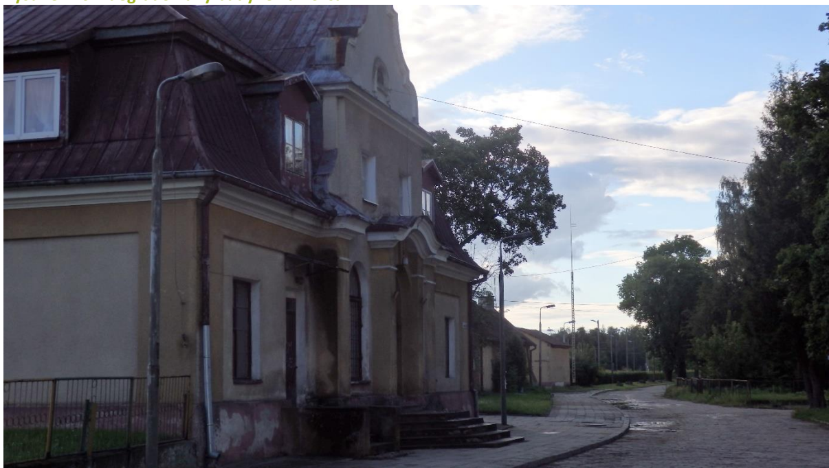
Rysunek 26. Zdegradowany budynek dworca PKP
