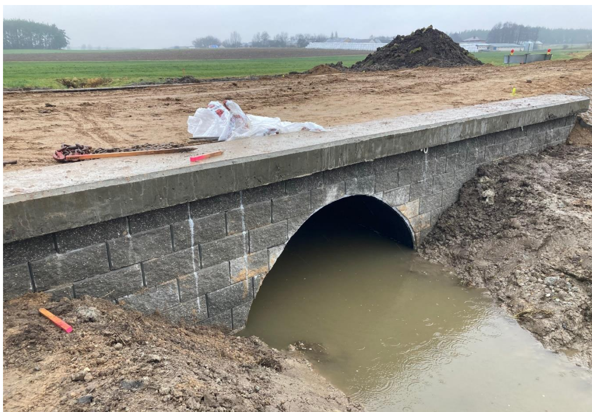
Budowa przepustu w miejscowości Dziękonie wraz z rozbudową i przebudową drogi gminnej Nr 140120B na odcinku od 0+000 – 0+017,00
